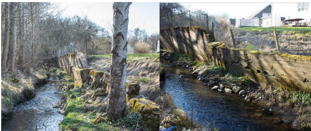
Figur 10. Lutande och sprucken stödmur.
