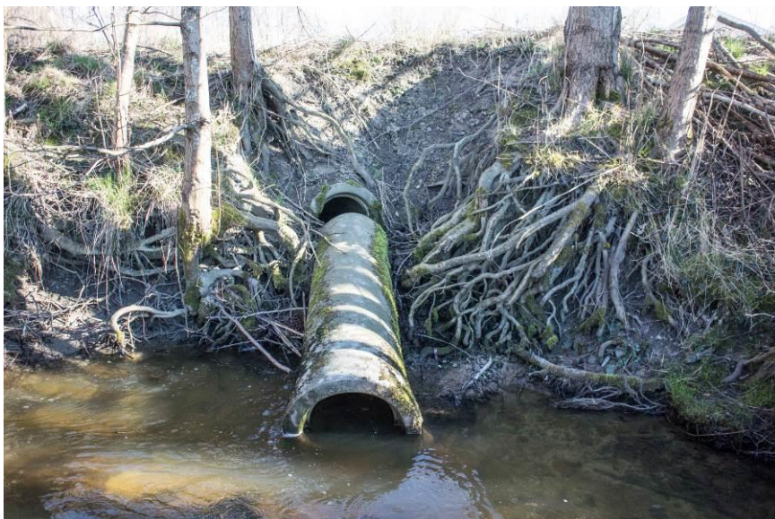
Figur 9. Punkt 4577, frameroderat rör.
