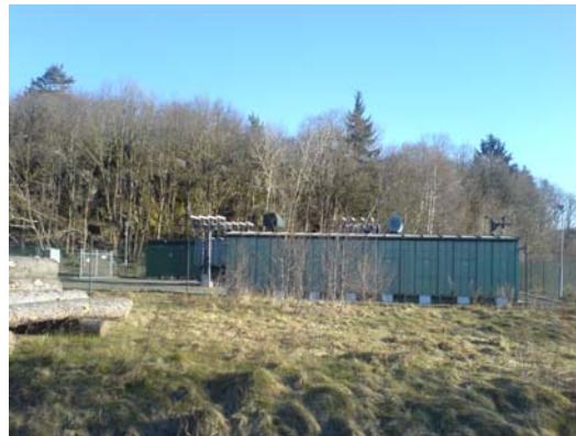
Vattenfalls transformatorstation i västra delen av programområdet.
