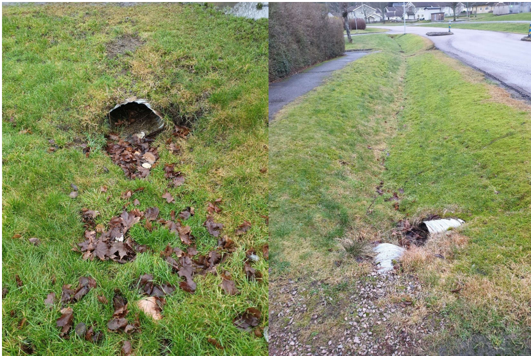
Figur 7. Trumma under Gallåsvägen från södra sidan av vägen; diket längs norra vägkanten, källa Tyréns.
