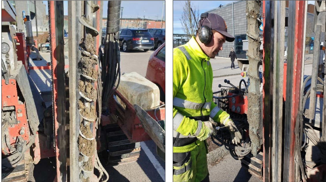
Figur 7. Till vänster Skr 2006 med fyllnadsmaterial under ovanliggande asfalt. Till höger Skr 2006 där man ser naturlig lera under fyllningen.
