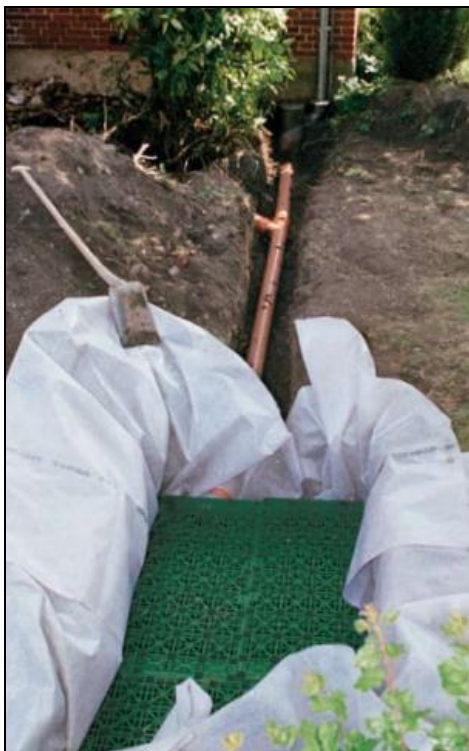
Figur 7. Exempel på utjämningsmagasin bestående av dagvattenkassetter
