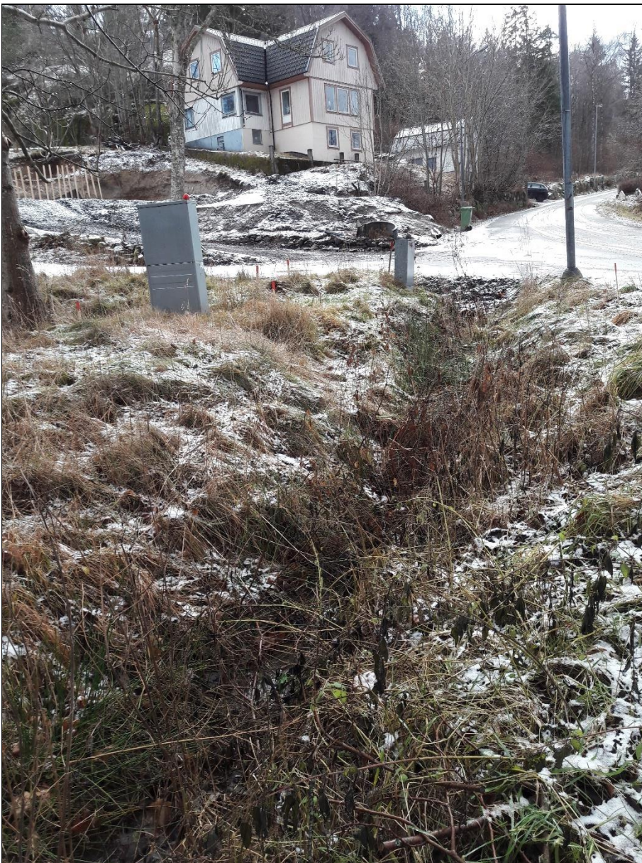
Figur 10. LTA-anläggning. (foto: Norconsult AB)
